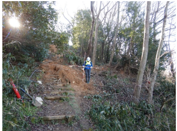
写真⑯ 崩土の主到達範囲末端 登山道が土砂で埋没
