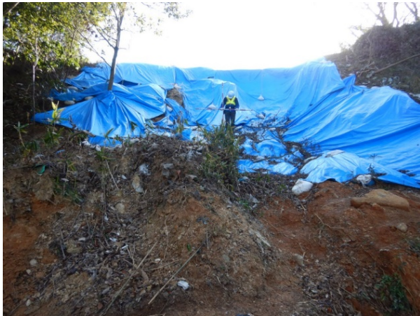
写真⑮ 崩壊地の状況 幅 12m、深さ 2.5m
