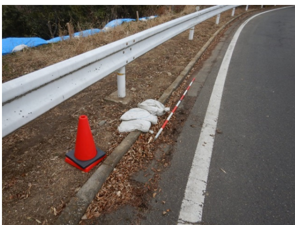
写真⑫ 距離標 No. 226+8m 付近 L 型街渠欠損部、土のうで応急対策
