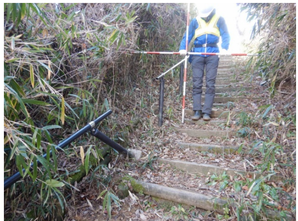
写真⑱ 登山道の手摺損壊
