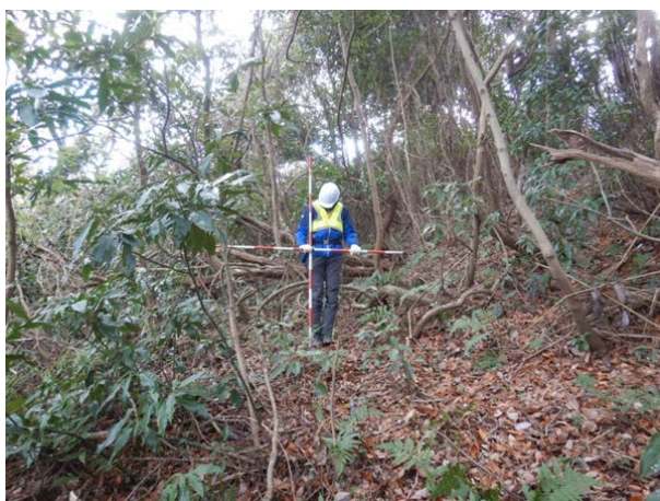
写真⑤ 起点側盛土のり面 灌木が生育
