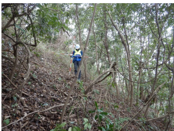
写真⑪ 距離標 No. 225m 付近 斜面状況 小規模な表層すべり、幅 6m、長さ 6m、 深さ 0.4m 立木が山側傾倒
