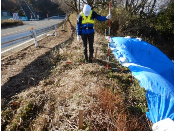
写真⑬ 距離標 No. 225+18～226+8m 付近 崩壊地背後
