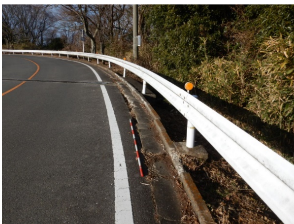
写真⑩ 距離標 No. 224～No. 224+10m 付近 延長 10m にわたり L 型街渠が沈下、 分離幅 10cm
