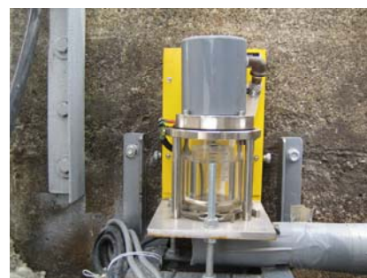
写Ⅱ-3-6 水盛式沈下計
