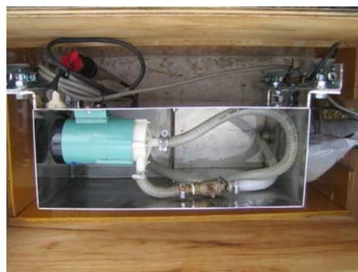
写Ⅱ-3-5 基準水槽内部
