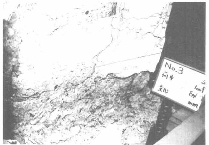
写真Ⅲ-3 損傷レベル3
