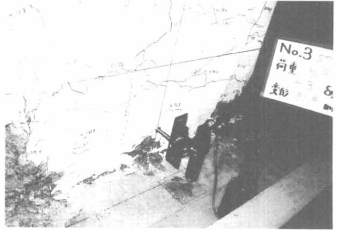
写真Ⅲ-2 損傷レベル2
